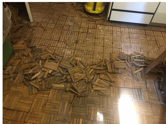
Das eingedrungene Wasser hat den Klötzli-Parkettboden zerstört
